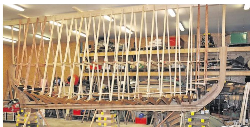
Vor einen paar Tagen erfolgte in der Halle die Kiellegung eines Börteboot-Neubaus.
