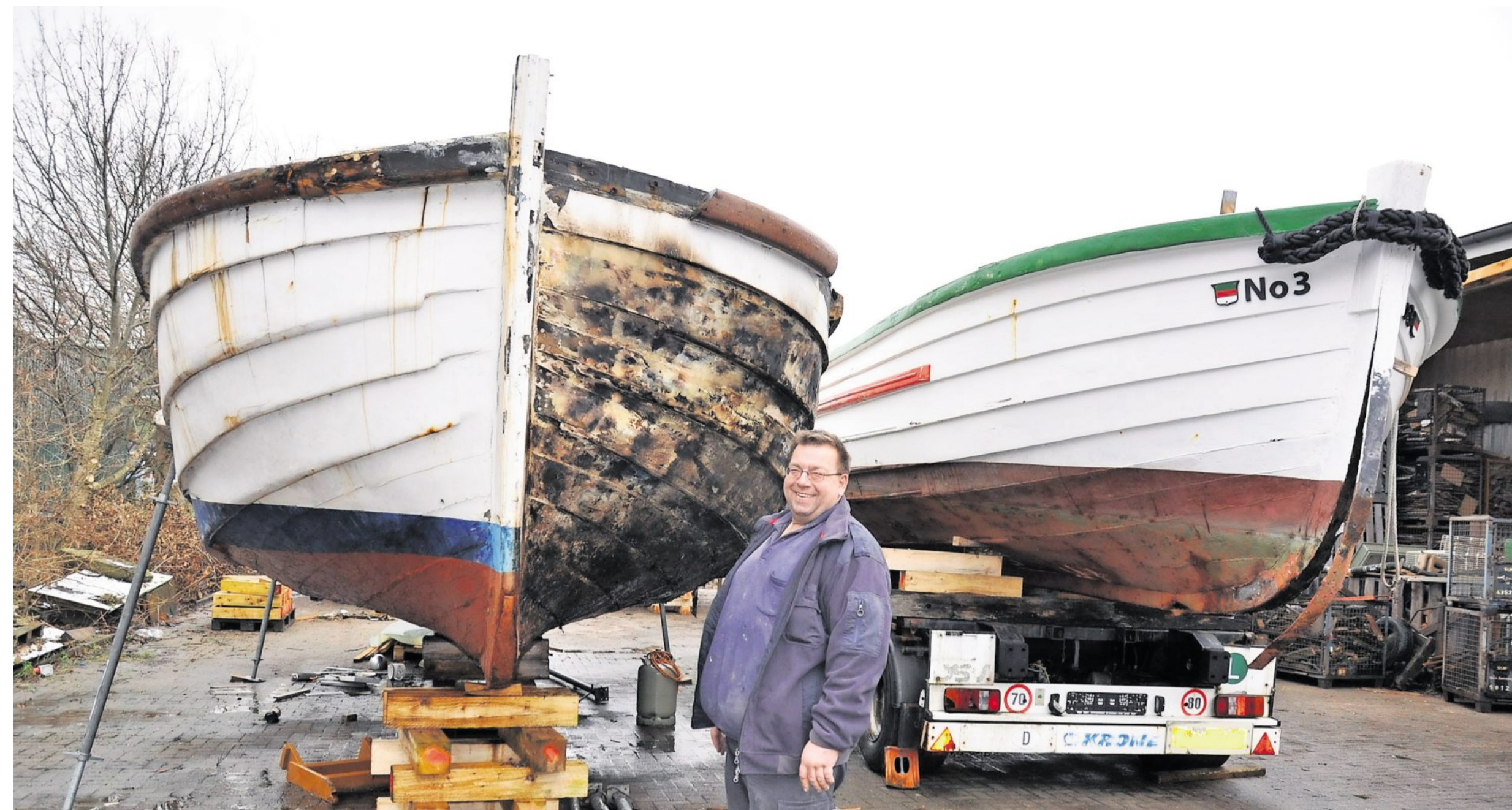
Jochen Crome hat den Hof seines Zimmereibetriebes in Bad Bederkesa voller Börteboote stehen. Aktuell rettet er erneut ein Börteboot vor dem drohenden Verfall: Das frühere Gemeindeboot „No. 4“ (links) möchte er wieder fit machen. Fotos: Kramp
